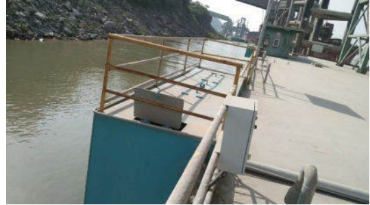
趸船外悬挂废水收集箱
