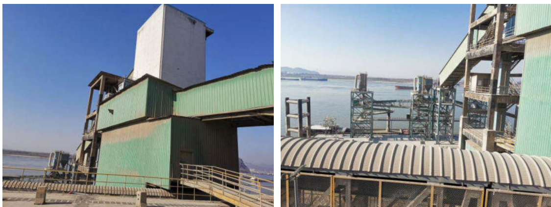
转运楼除尘器
